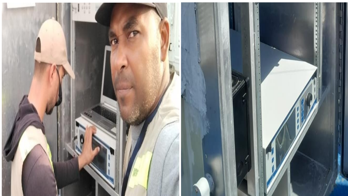
ANALIZADOR DE OZONO O3 MARCA SABIO AUTOMÁTICO
